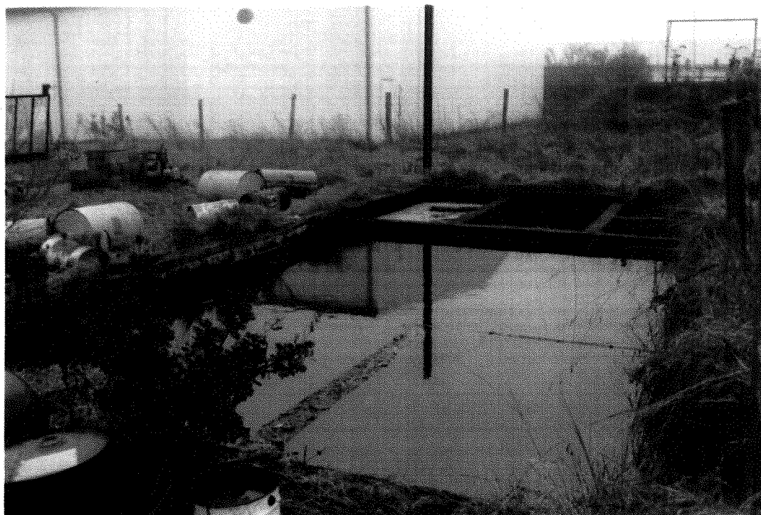
Photo 11 : le décanteur plein
