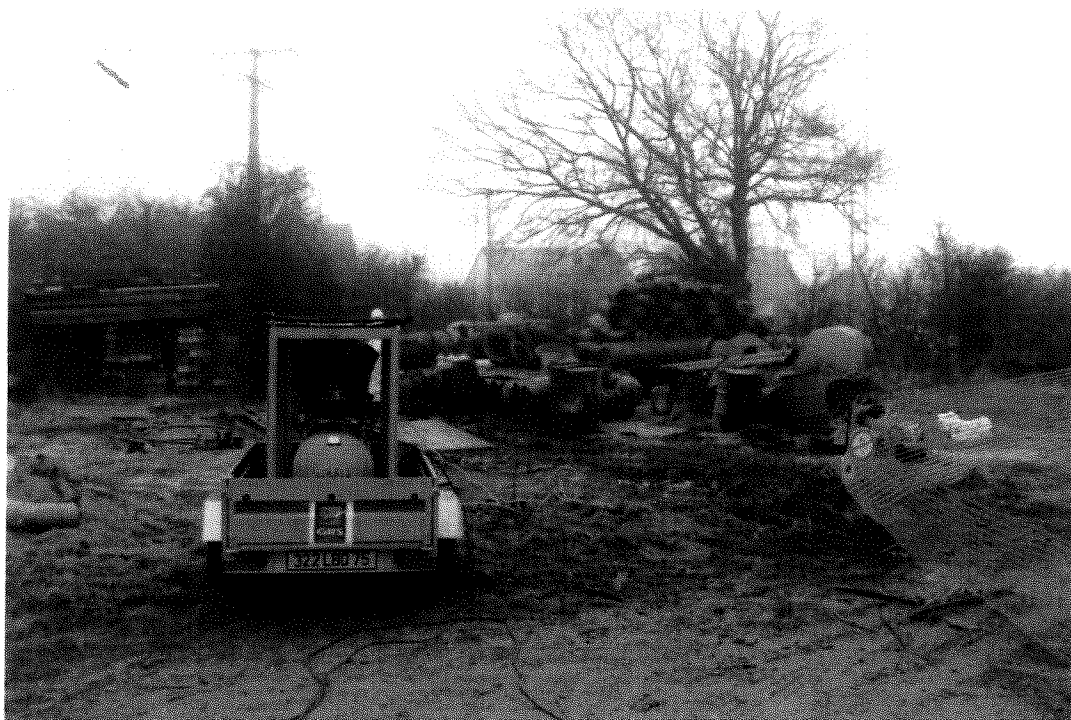
Photo 10 : le compresseur et les fûts plastiques
